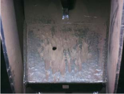
Verschleiß im Ventilator
